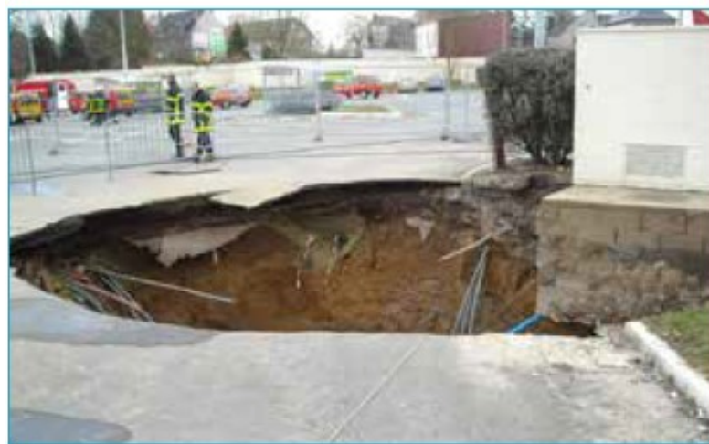
Illustration 1.27 : Effondrement de chaussée, Bapaume (62) [crédit BRGM, sd]
